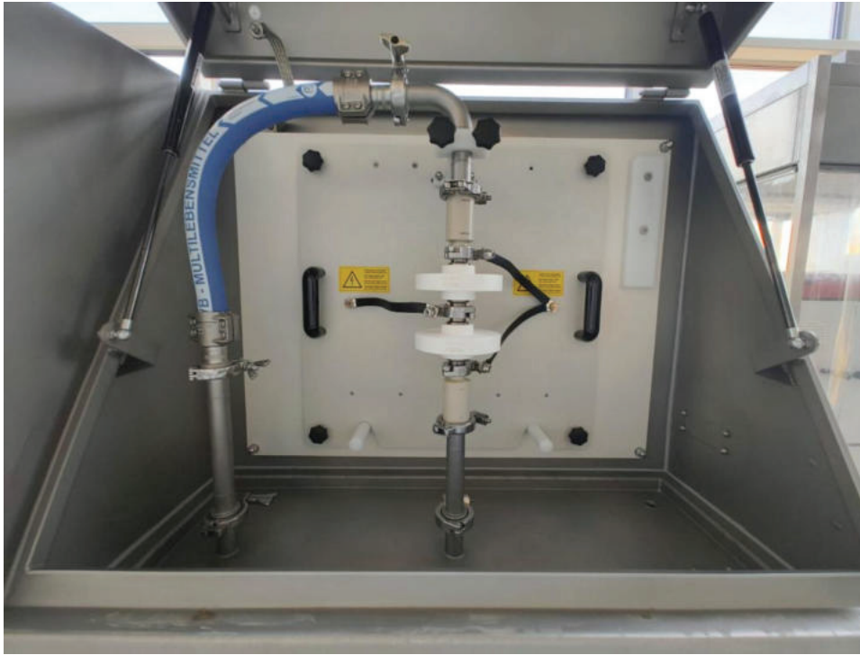
Abb. 34: Ansicht Modulplatte kontinuierlicher Betrieb (eigene Aufnahme)
