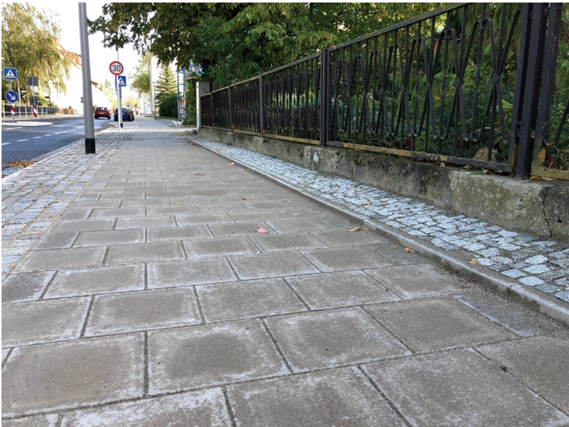
Abbildung 1: Kürzlich sanierter Gehweg in der Ziegelbergstraße mit 30x30 cm Betonplatten. Der äußere Rand des Gehwegs wurde mit Mosaikpflaster befestigt, aber morphologisch durch einen Rasenbord vom Gehweg getrennt und verschleißt sich dadurch einer Nutzung. Quelle: Eigene Aufnahme aus Oktober 2023.
