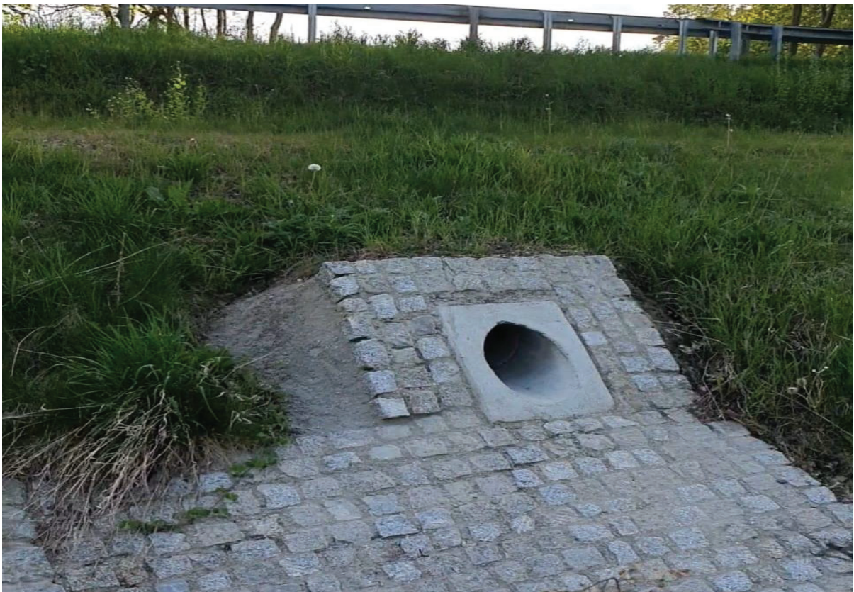
Ansicht eines Otterdurchlasses im ersten Abschnitt des Untersuchungsgebietes
