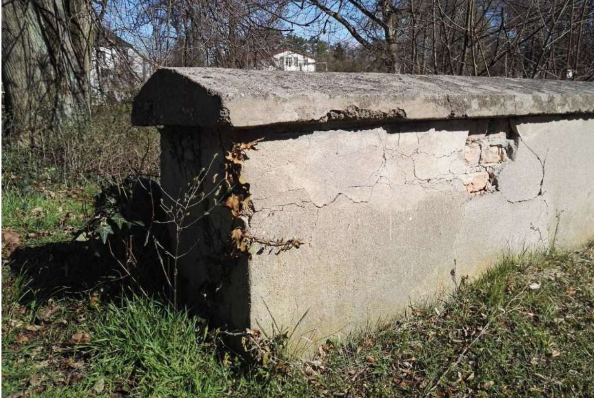
Mauern entlang der Einfahrt: stark geschädigte Mauer (Klinkermauerwerk, verputzt, mit Betonabdeckung)
