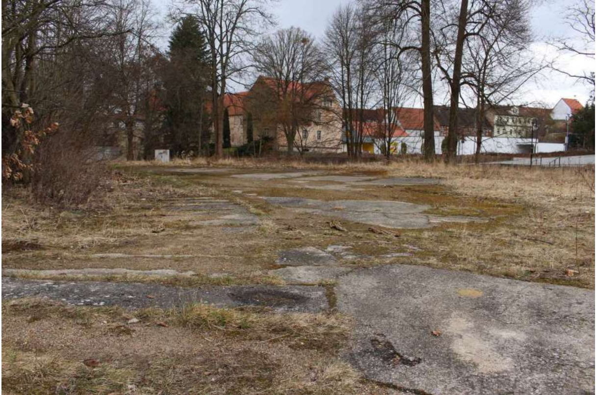
„Platz“ am südlichen Flügel des Schlossgebäudes: stark vermooste, verkrautete Betonplatten
