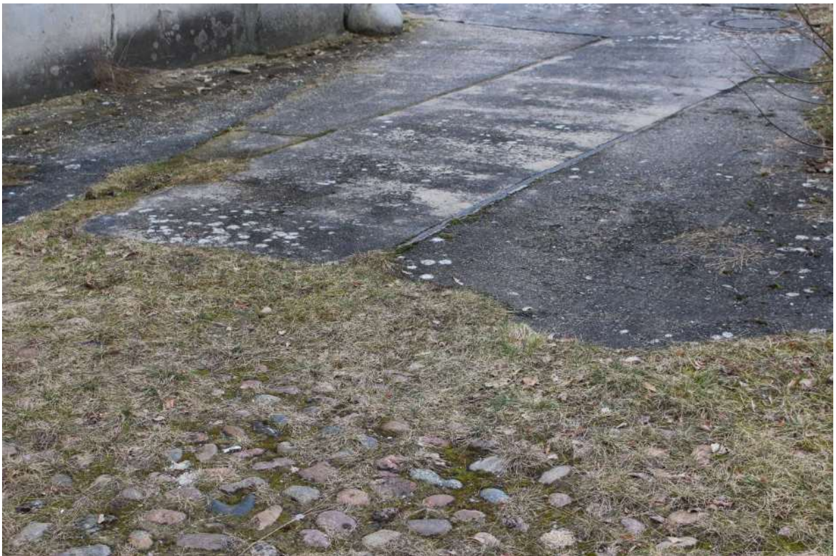
Belagswechsel am Übergang zum Weg aus Beton um das Schlossgebäude: stark verkrautetes, vermoostes Natursteinpflaster (Flusskiesel)
