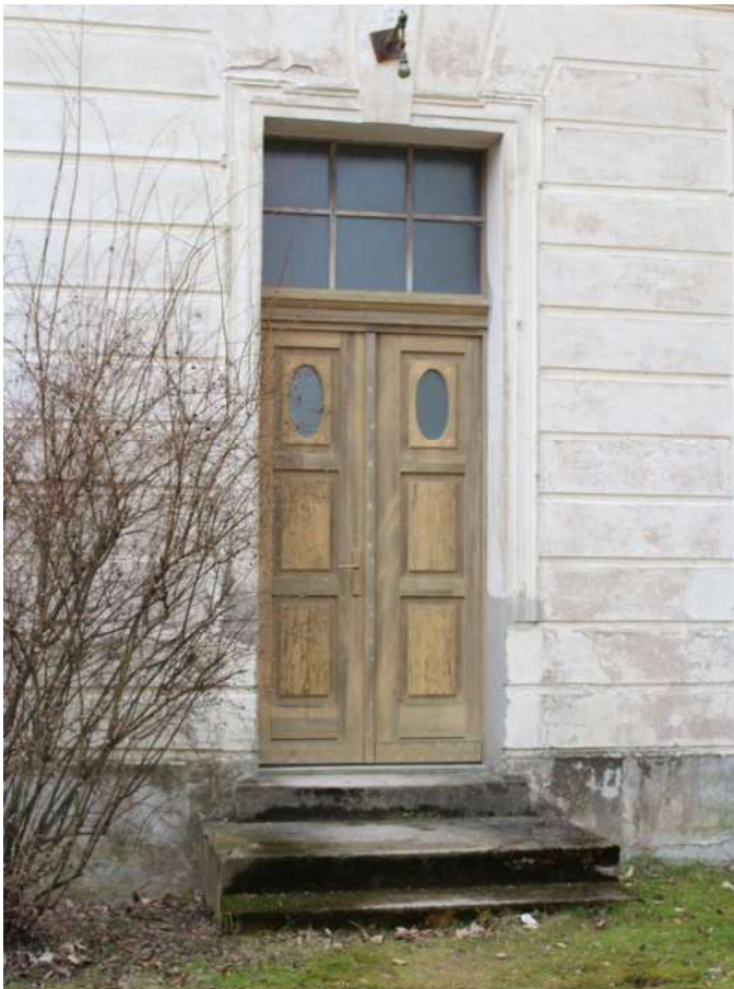
Eingang westl. Seitenschiff: Stufen aus Beton, stark vermoost
