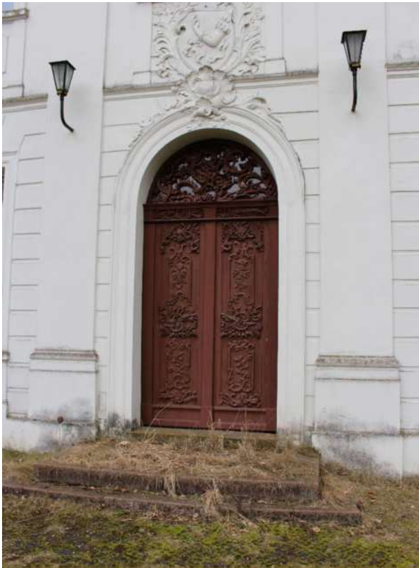
Haupteingang Mittelrisalit: Stufen aus Naturstein (Porphyr) verschoben und verkrautet
