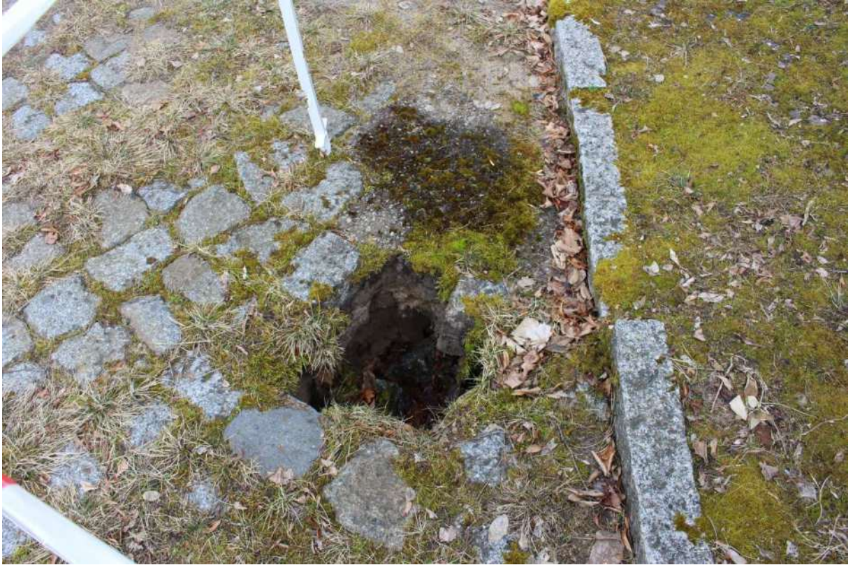
Einfahrt zum Schloss: schadhafte und stark verkrautetes Natursteinpflaster (Granit, grau) mit Granitborden zur Abgrenzung als Einfahrt zum Schloss
