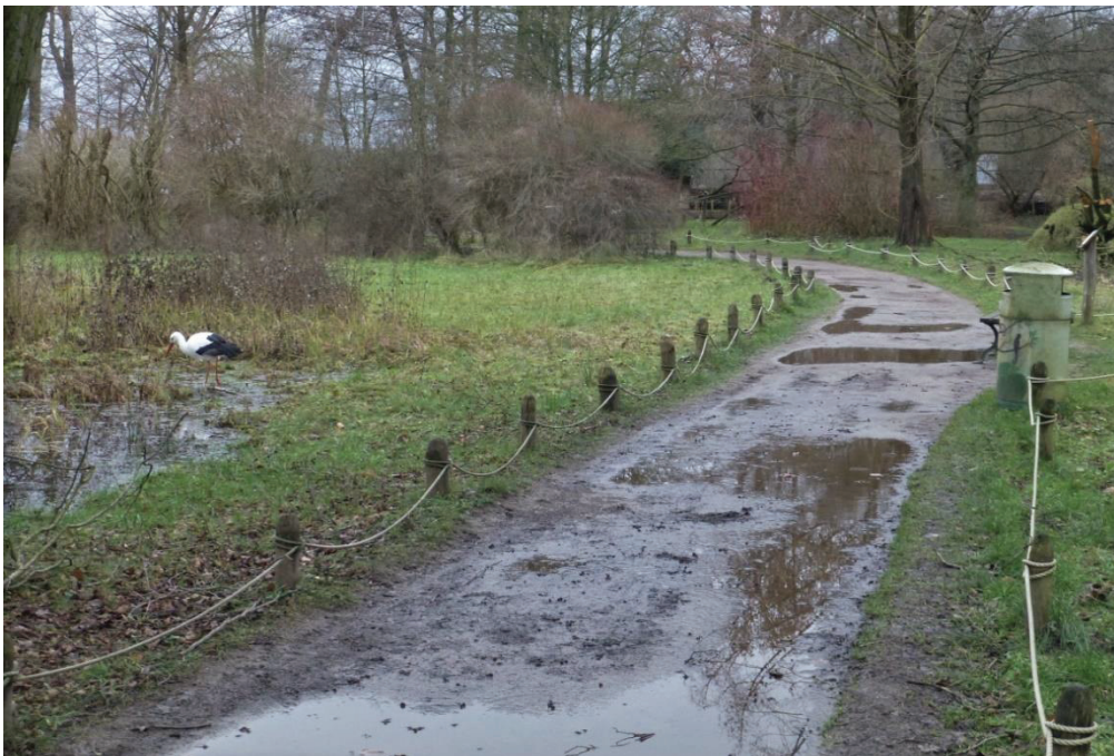
Abb. 32: Zum Teil unter Wasser stehender Gehweg in dem für Besucher begehbaren Teil der Wasservogelanlage im Januar 2018 (Foto SCHRÖDER 2018)
