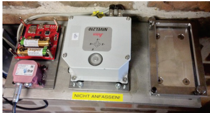
Abbildung 124: Messstation 1 mit Sensoren
