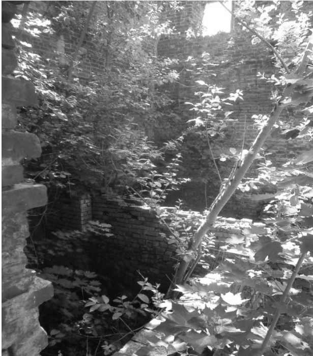
Abb. 22 An dieser Stelle des "Krummen Hauses" wurde der Sukzession freien Lauf gelassen.
