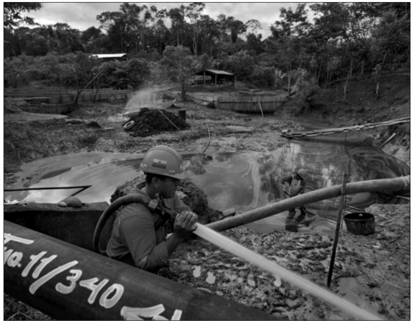
Abb. 39: Reinigung eines ehemaligen Ölbohrlochs von 1976. Die Verschmutzung hat nicht nur Folgen für die Umwelt. Viele der Arbeiter und deren Familien haben über gesundheitliche Beschwerden
