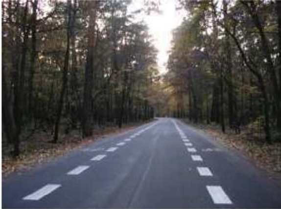
Abb. 117: Straße mit Radwegemarkierungen
