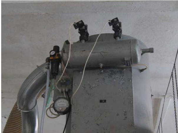
Abbildung 12: Druckluftspeicher mit Magnetventilen
