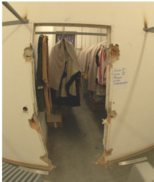
Abb. 5.1: Hindernis beim Scannen
