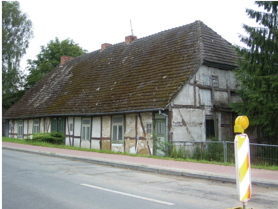
Abb. 42: stark verfallenes Niederdeutsches Hallenhaus in Kessin – 13 0 51 035/ 02 HAS (Quelle: eigene Erhebung)
