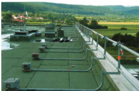
Abb. 39 : Temporäre Absturzsicherung (Quelle: BÖCKMANN, 2007)
