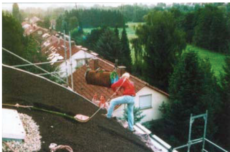
Abb. 37 : Absturzsicherung über Seile (Quelle: KOLB, 2003)
