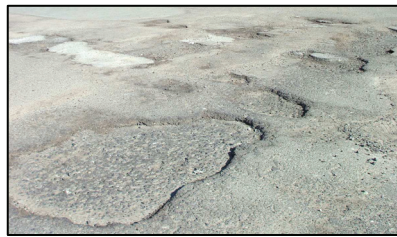
Abb. 16: Schäden in der Fahrbahn (Quelle: FÖRSTE, 2009)
