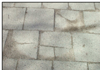
Abb. 18: beschädigte Betonplatten (Quelle: FÖRSTE, 2009)
