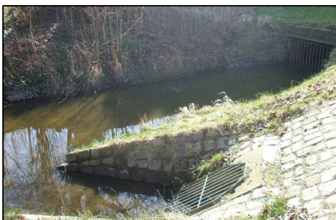
Abb. 41: Zufluss mit Einleitung (Quelle: FÖRSTE, 2009)
