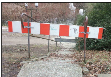
Abb. 14: abgesperrte Treppe (Quelle: FÖRSTE, 2009)
