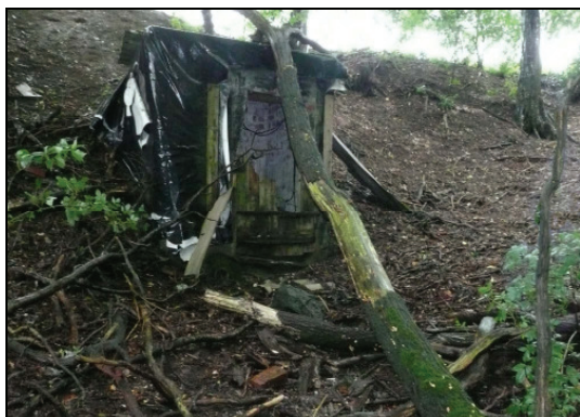
Abb. 49 Pumpenhaus (Quelle: Eigene Aufnahme, August 2008)
