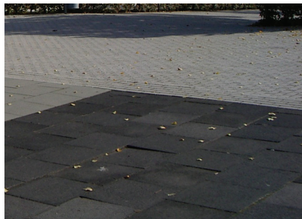
Abbildung 29: Der Belag hat sich gesenkt – Kreuzung
