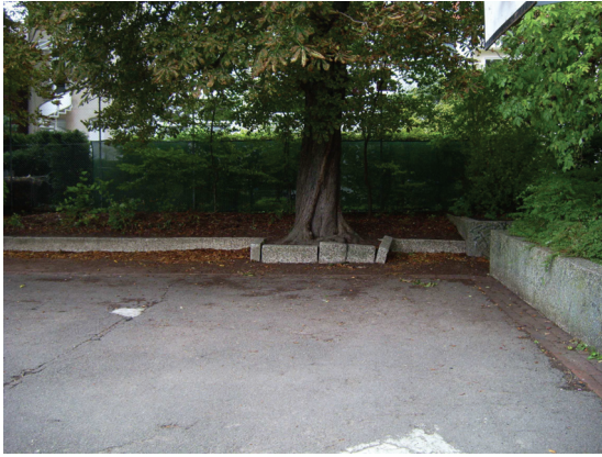
Abb.: 4 abgängerige Asphaltfläche des Basketballplatzes
