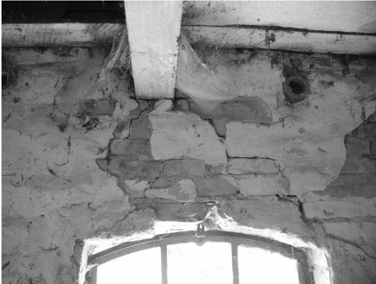
Abb.: 31 Rissbildung Außenwand Werkstatt
