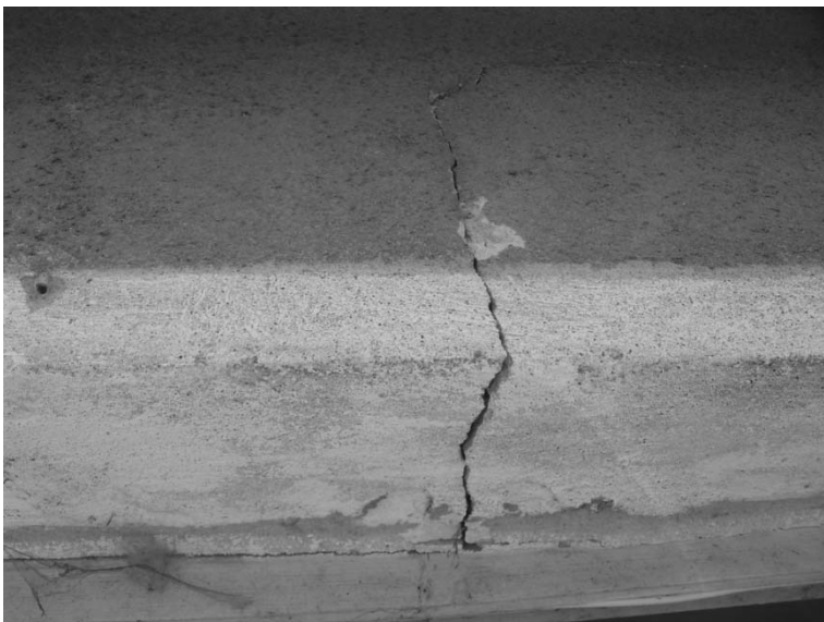
Abb.: 06 Rissbildung Fenstersturz Esszimmer Straßenseite
