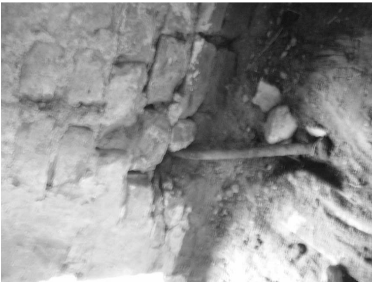
Abb.: 38 Durchwuchs von Wurzeln
