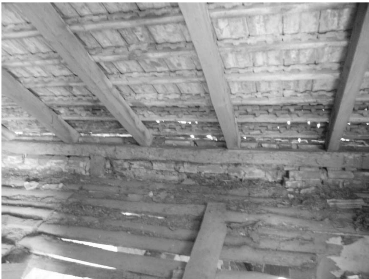
Abb.: 26 Wurmbefall Schwelle Hofseite Nordost
