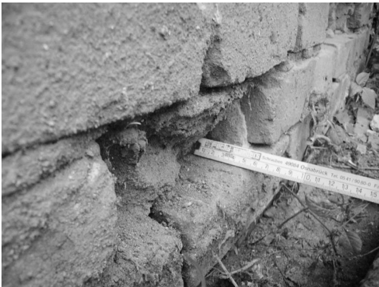
Abb.: 04 Feuchtigkeitsschaden Hofseite Nordost
