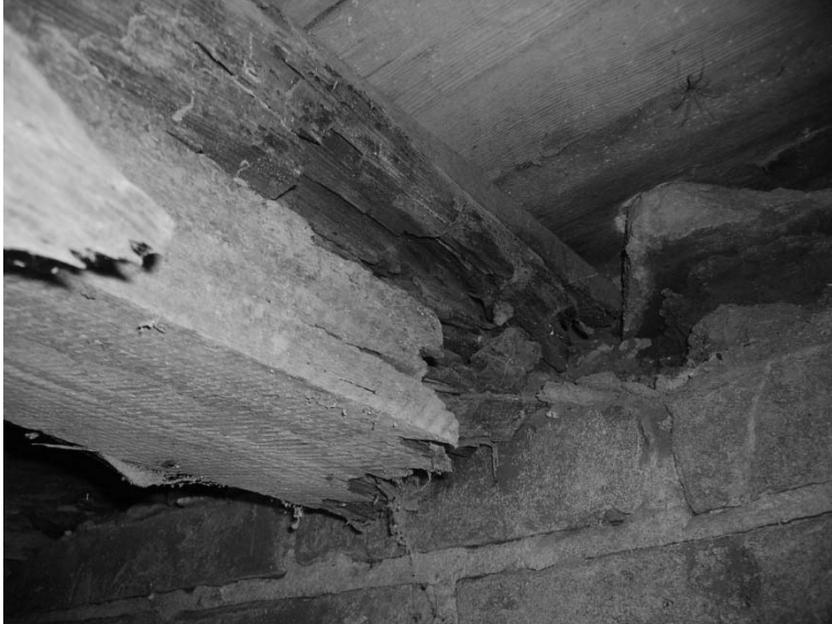
Abb.: 13 Vermoderte Deckenbalken
