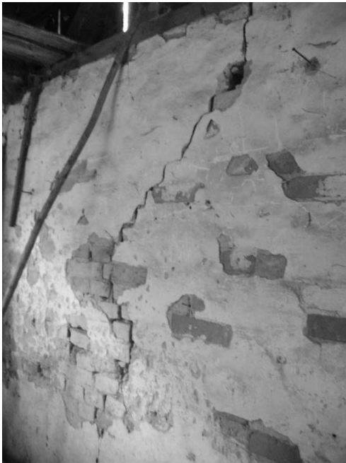
Abb.: 32 Rissbildung Außenwand Garage
