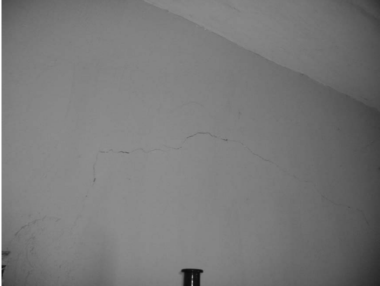
Abb.: 39 Trennwand Rissbildung
