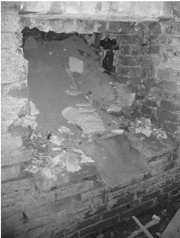
Abb.: 16 Zerstörter Kellerschacht
