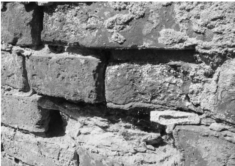
Abb.: 10 Ausblühungen Giebel Südost
