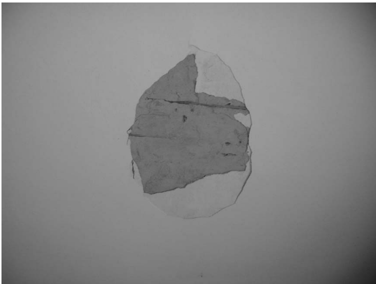
Abb.: 40 Abplatzen des Deckenputzes
