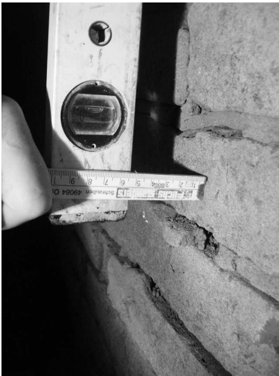
Abb.: 22 Ausbeulung Kellerwand Bild 2
