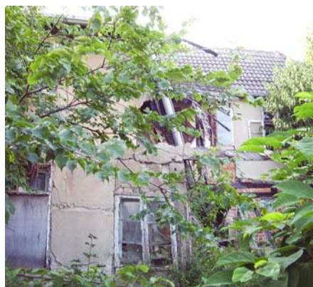
Abb. 12, Zusammengefallener Anbau Haus I
