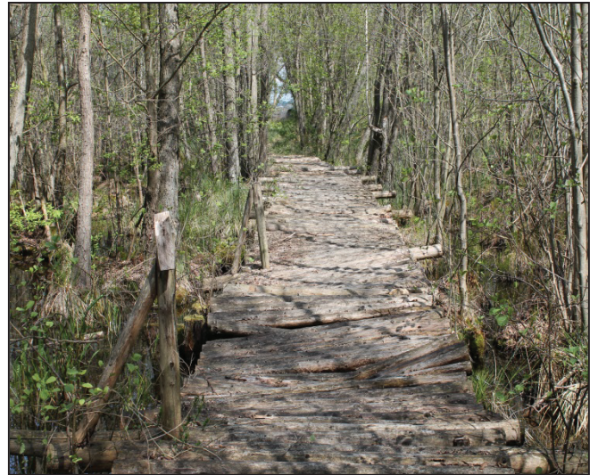
Abb. 65 Derselbe Standort acht Jahre später. Der Handlauf ist zu großen Teilen weggebrochen. Die Randhölzer sind abgesackt, wodurch auch die Rundhölzer stark in Mitleidenschaft gezogen wurden.
