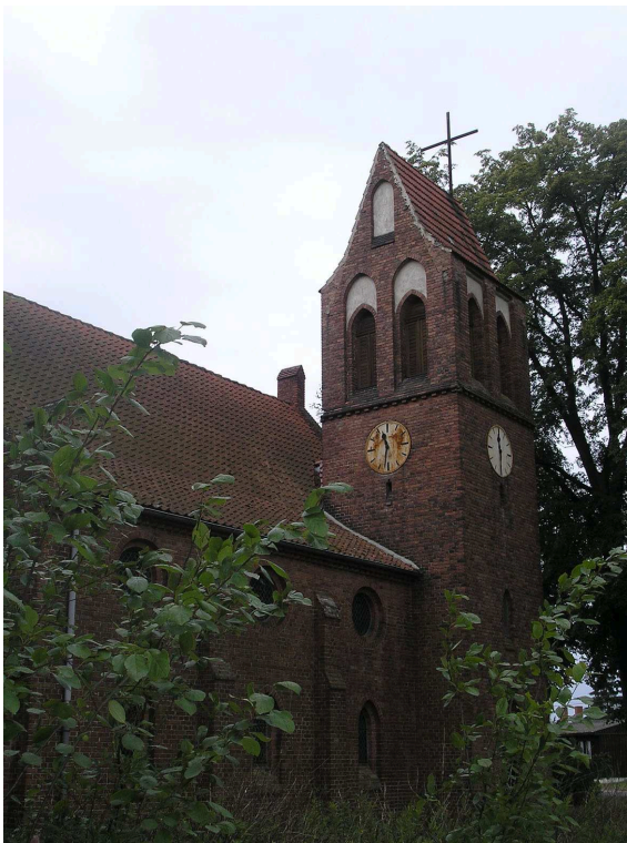
Abb. 5.16: Sanierungsbedürftige Kirche von Kappe Foto: Franziska Behrens
